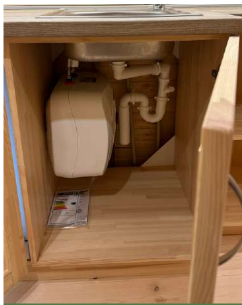
Boiler da 10 l sotto il lavello
